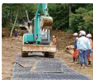
災害復旧現場
